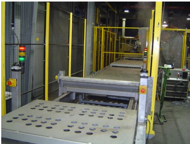
Bild 3: Anlage im Probetrieb mit teilweise errichtetem Schutzzaun; Not-Aus-Kreise und optische Warn-einrichtungen sind bereits funktionsbereit
